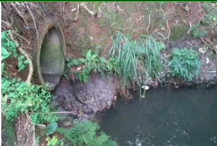
Foto 3 – Tubulação de água pluvial, com indícios de ligação cruzada com rede de esgoto no trecho entre os pontos 1 e 2.
